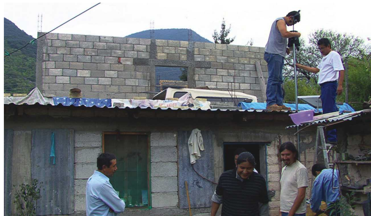
Figura 6. Instalación de la estación climatológica automática en Palomas, Xichú, en 2008.
